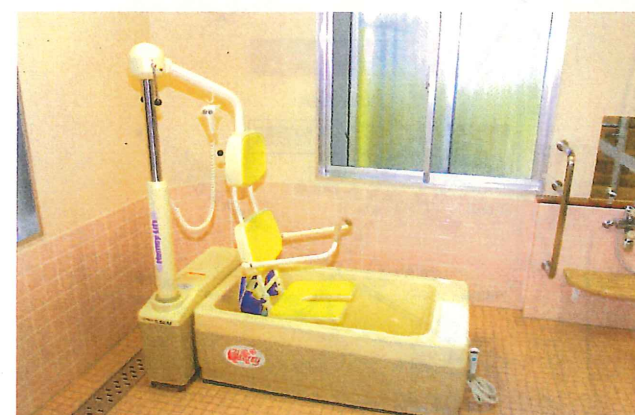
2F ルビーホーム リフト式浴槽
