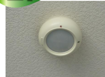
玄関天井設置の 人感センサー
