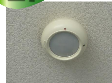
玄関天井設置の 人感センサー
